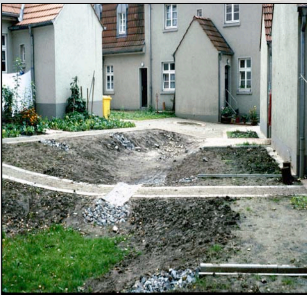
Bild 38: Durch den Bau von Versickerungsgräben, kann das Regenwasser wieder in den Boden versickern.
